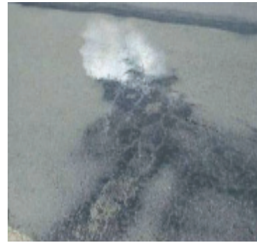
写真-3 亀裂と白い物質
